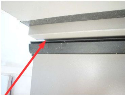
Netěsnost fasády – těsnění se nedotýká výplňového panelu.
