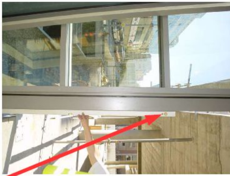
Fasádní sloupek není osazen svisle – oba na vzorku.
