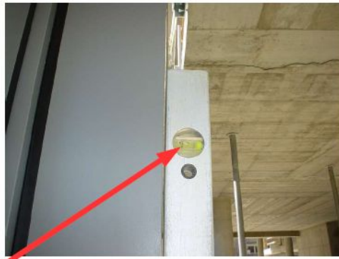
Fasádní sloupek není osazen svisle – přední.
