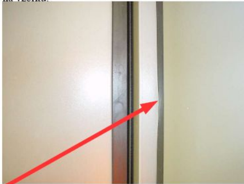
Nekvalitně provedená montáž - deformace těsnění.
