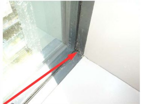
Spojení vnitřních těsnění není provedeno v souladu se směnicí dodavatele hliníkového systému.
