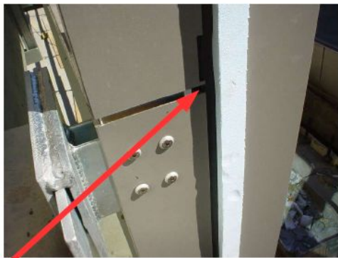
V detailu chybí řada systémových prvků hliníkového systému.
